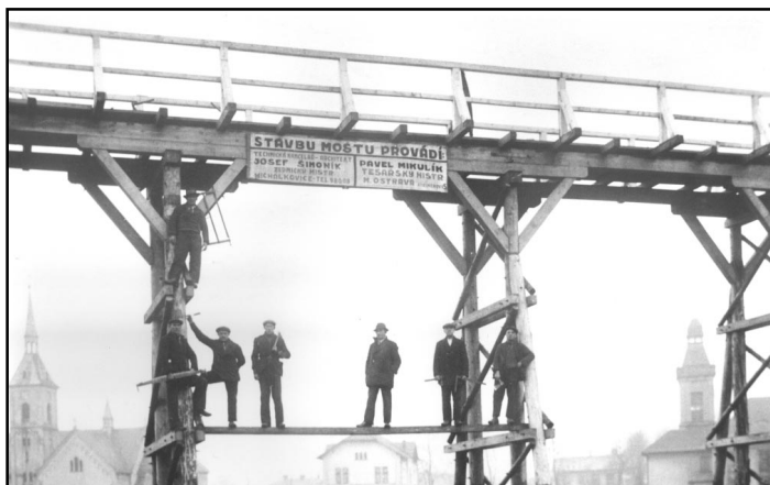
Výstavba dřevěného mostu pro odvoz hlušiny důlními vozíky na haldu ve čtyřicátých letech 20. století.
